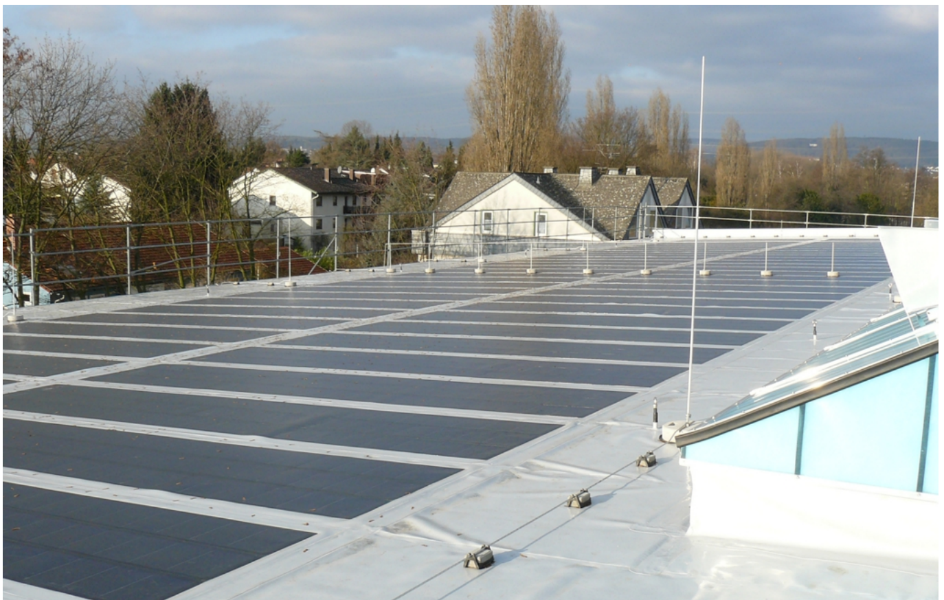
Photovoltaikanlage auf der Sporthalle am Karl-Eckel-Weg
