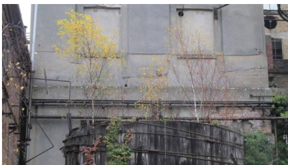
Abb. 32: Gehölze auf einem Bauwerk / einer Dachfläche
