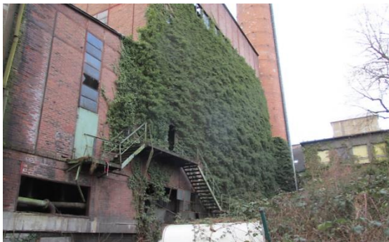
Abb. 28: Stark ausgeprägter Efeubewuchs an Gebäudefassade
